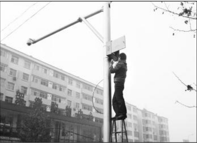
近日，记者从后勤管理部了解到，山西铝厂“天眼”工程相关设施已安装到位，进入信号调试阶段，预计十二月中旬完成全部信号调试工作。届时，这些设施就正式“上岗执勤”，为打造铝城平安、和谐生活保驾护航。图为工作人员正在进行信号调试。 摄影报道 本报记者 张斌
